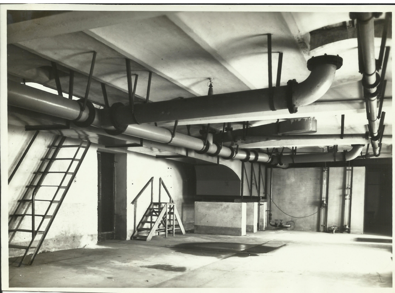
Idraulica: Condotte di alimentazione
